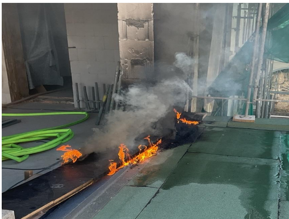
11.04.25 Brand Dachpappe Bild Feuerwehr
